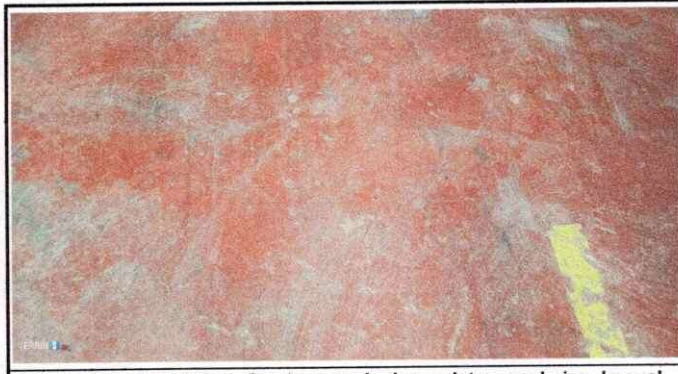
Foto 6: Aula 2 Modulo 1, Se observa el micro grietas en el piso, lo cual como resultado se tendra el levantamiento del mismo.
