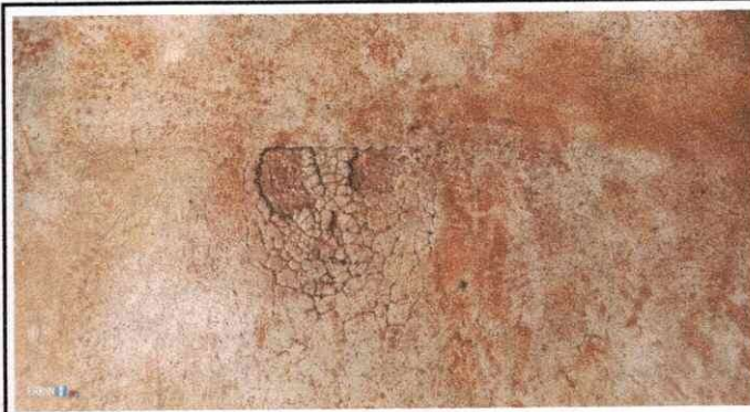
Foto 4: Piso pasillo Modulo 1. Se logra observar que debido al ingreso de las lluvias a afectado el piso, dando lugar a la perdida del alisado.
