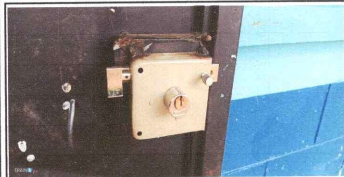
Foto 5: Chapa 1 Modulo 2. Se observa el mal estado de la chapa ya que no abre con la llave.
