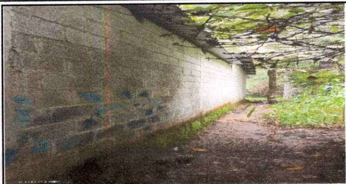
Foto 1: Parte de atrás del Modulo 1. Se observa que muestra humedad, debido a las constantes lluvias.
