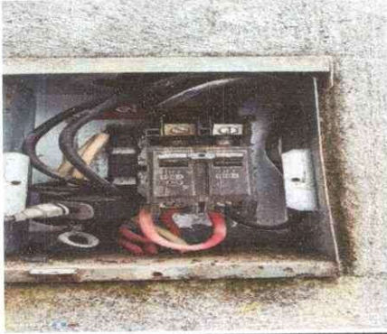
Foto 1: RH. La caja principal de energía eléctrica está llena de sarro y mal estado.
