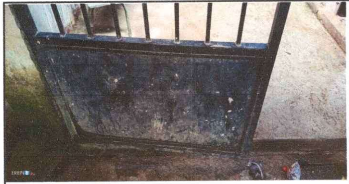
Foto 3: Porton principal, Se observa que es necesario de nuevo repintar el porton por el mal estado en que se encuentra.
