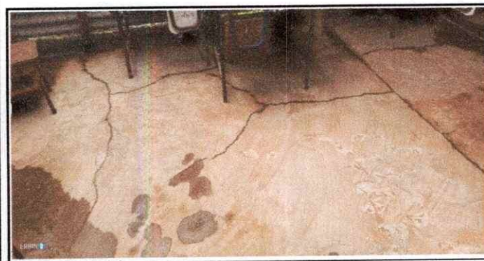
Foto 5: Aula 1 del modulo 1, Se puede observar el agrietamiento del entortado debido al mal estado del suelo por el ingreso de lluvias.
