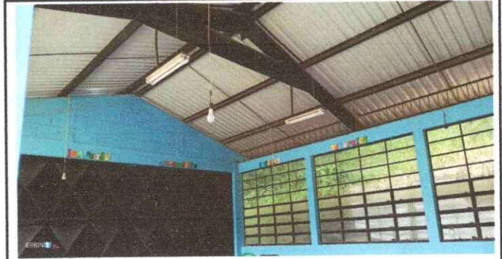
Foto 2: Modulo 2. No funcionan las lámparas de este modulo.
