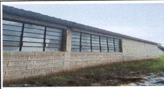
Foto 2: Parte lateral derecho Modulo 1. Se observa la acumulación de humedad, la cual afecta los materiales internos de las aulas.
