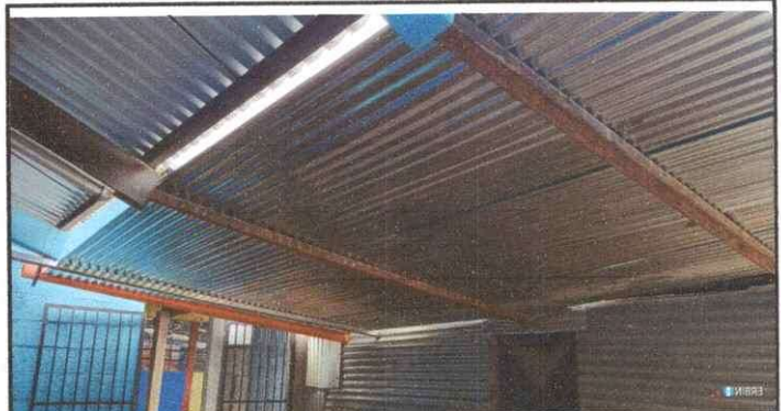
Foto 4: Estructura techo modulo 1. Se observa que el techo no esta totalmente asegurado ya las costaderas solo estan sujetas con alambre y las laminas sin atornillar.
