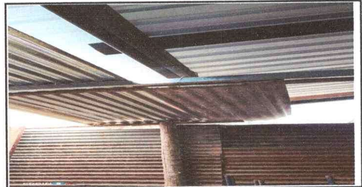
Foto 6: Estructura techo modulo 1. Se observa que solo hay una costadera sujetando las laminas y la cual esta sujeto con alambre de amarre.
