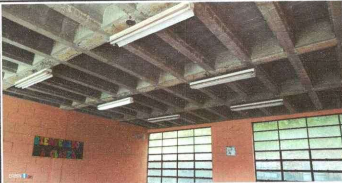
Foto 3: Iluminación del modulo 3, no funcionan al igual que los tomacorrientes, por lo cual se debe cambiar las líneas principales.
