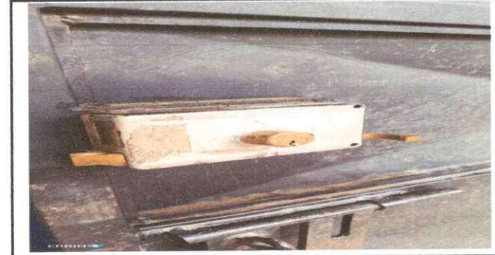
Foto 6: Chapa 2 Modulo 2. Se observa el mal estado de la chapa la cual no sirve el tope de la chapa.
