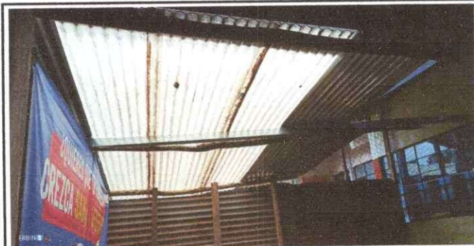
Foto 5: Estructura techo modulo 1: No se cuenta con una estructura formal, esta sujeto con palos, los cuales se encuentran en mal estado y sujeto solo con alambre de amarre.
