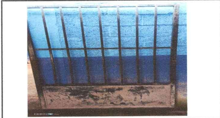
Foto 1: Porton principal. Se observa el mal estado del porton que por las constantes lluvias se ha oxidado, por lo cual es necesario el cambio de planchas de metal.
