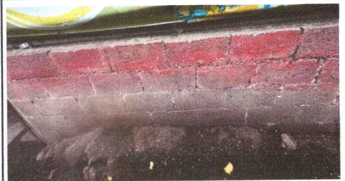
Foto 2: Muro perimetral modulo 1. Se observa que el muro perimetral no cuenta con repello por lo cual ingresa la humedad y en invierno se inundan las clases.
