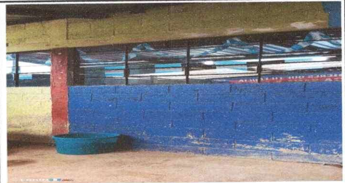
Foto 4: Pintura Muero Modulo 1. Se observa que no se ha culminado de pintar las aulas.
