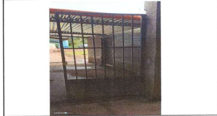
Foto 2: Porton Principal. Se observa que es necesario la modificación y mantenimiento de porton debido a que no se puede abrir en su totalidad de un lado debido a su altura con el techo.
